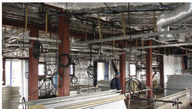
MAIN SWITCH ROOM 内部
