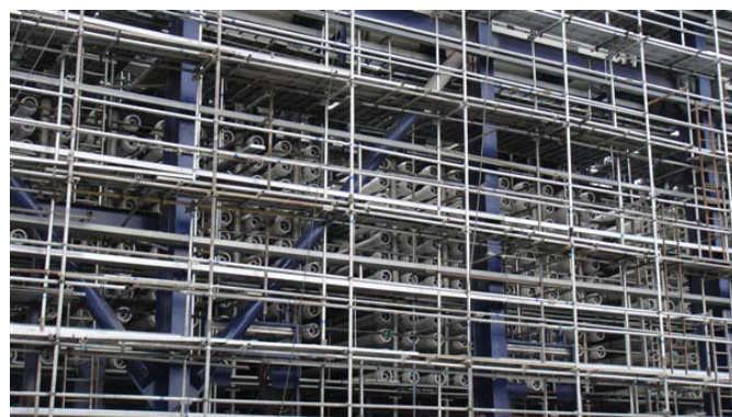
海水淡化RO模块外部
